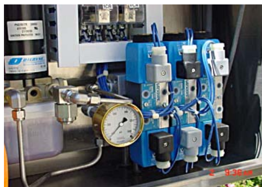
Caixa de comando hidráulico
