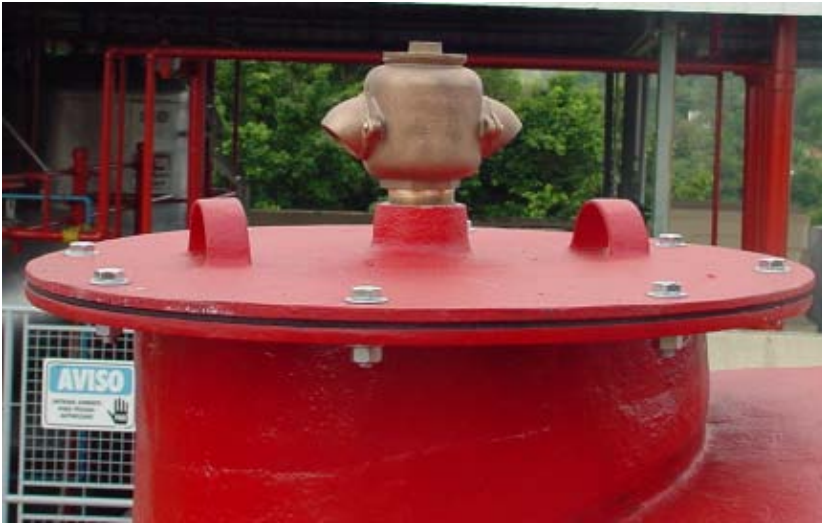
Válvula VAQ2 instalada em tanque de LGE
